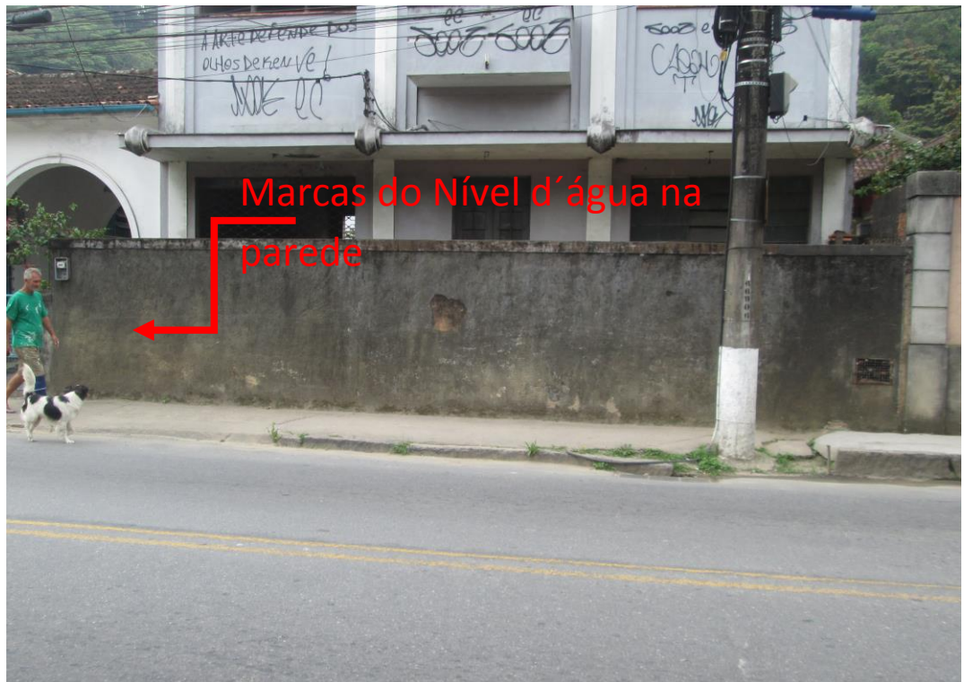
Figura 11: Ponto crítico de inundação na Rua Coronel Veiga
