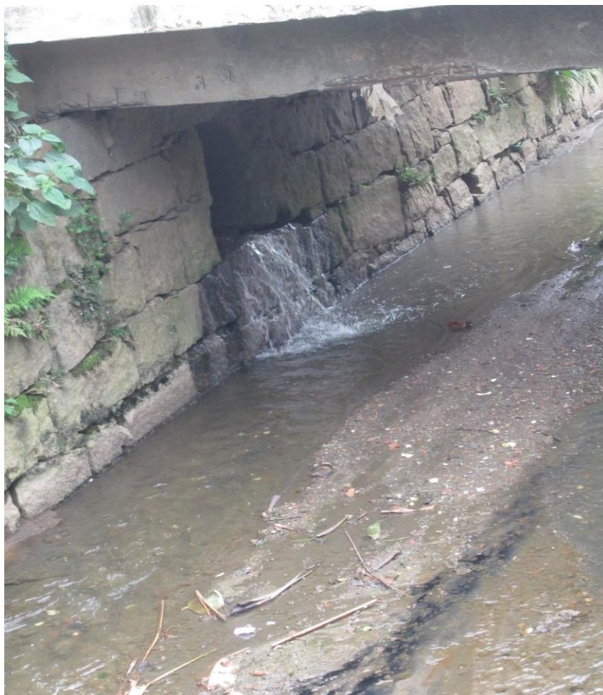
Figura 17: Seção assoreada, com despejo de esgoto
